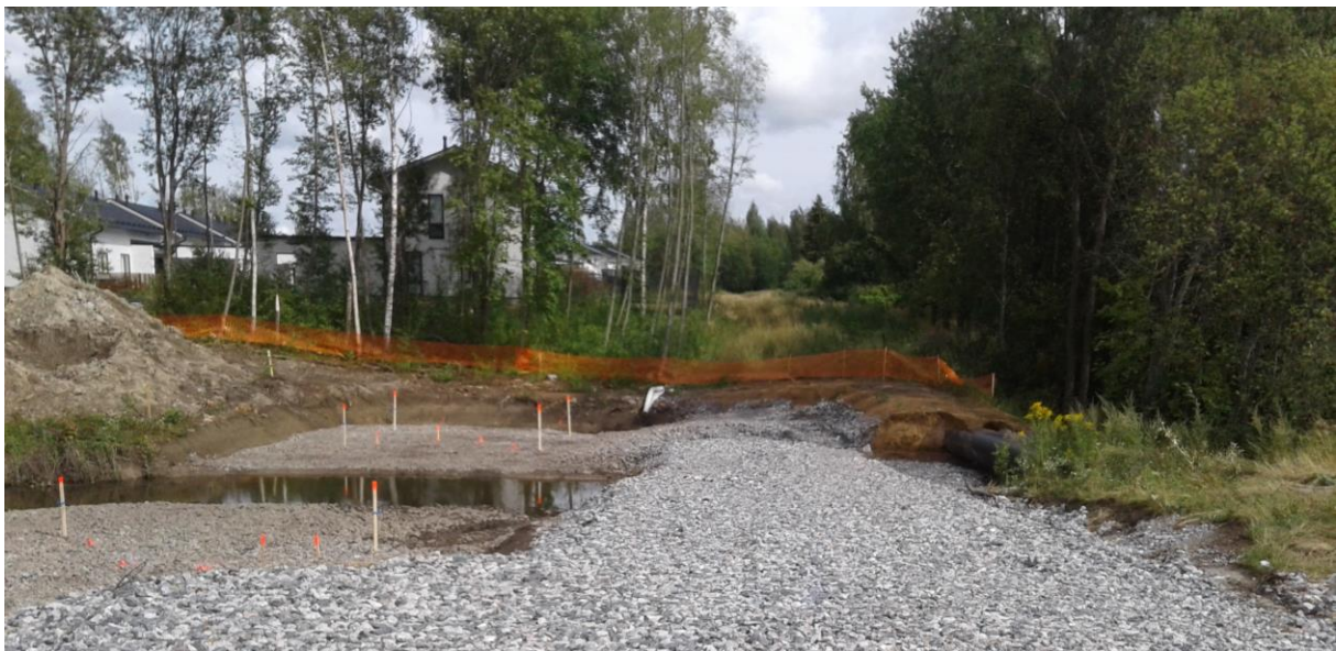
Kuva 7. Koisotien eteläpuolella sijaitsevan siltatyömaan väliaikainen patorakennelma, joka voi estää taimenten nousun kudulle, mikäli sitä ei poisteta aikataulun mukaisesti syyskuussa 2021.
