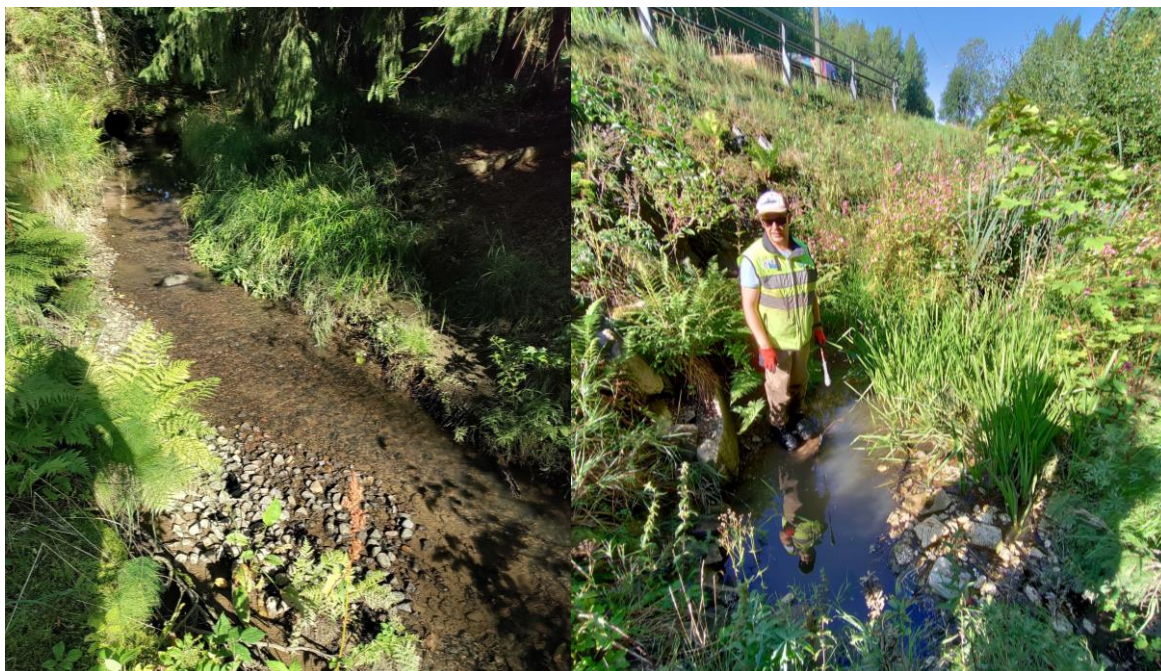
Kuva 9. Myrtilinja 1 virtapaikalle oli huuhtoutunut yläpuolisesta tiestä soraa (vasen) ja virtapaikan alapuo- lella tierumpu oli veden alla ja sen edustalla kellui styroksia ja muuta roskaa.
