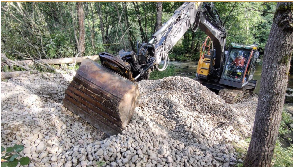
Kuva 6. Matarinkosken soraistuksen aloitusvaihe, jossa sorasta muodostettiin ramppi, jota pitkin kaivinkone ajettiin uomaan.
